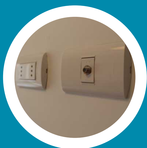
PUNTOS DE TELEVISIÓN POR CABLE ENTUBADOS
